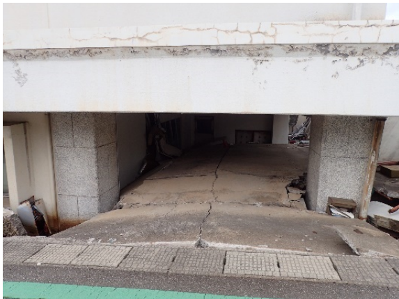
沈下した地盤
