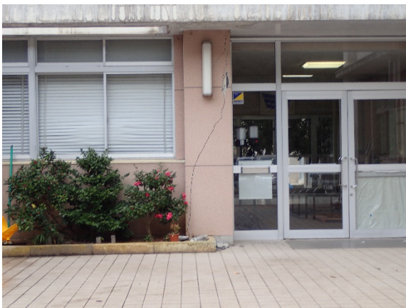
腰壁付き短柱のせん断ひび割れ
