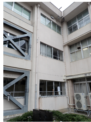
面外方向に捩れた事で生じたせん断ひび割れ
