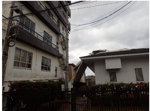
崩壊した外階段
