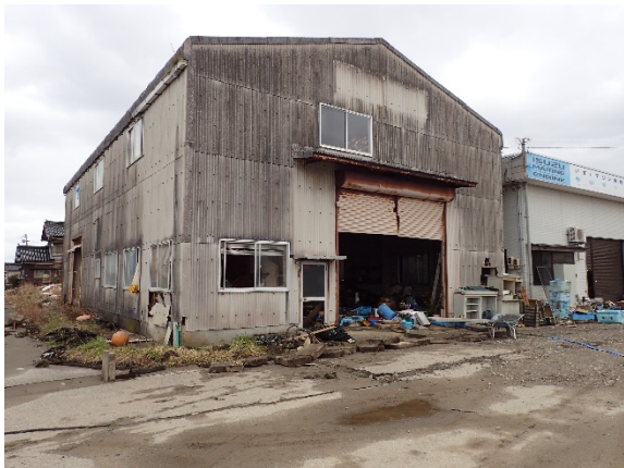
地震後の倉庫全体
