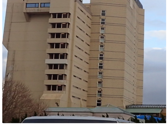
縦型開口部分の境界梁にせん断ひび割れ
