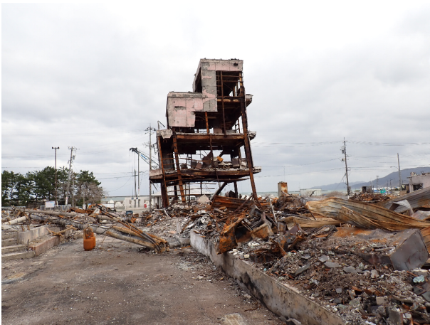
傾斜した4階建て鉄骨造建物
