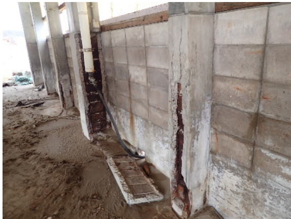
腐食したコンクリート内部の鉄骨柱
