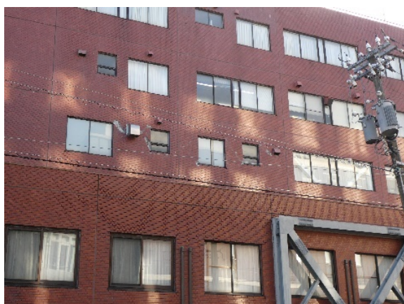
方立壁のせん断ひび割れ
