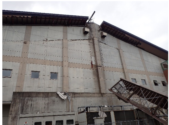
妻壁頂頭部の外部階段の崩落
