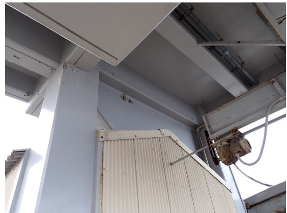
壁頭及び梁接合部のひび割れ
