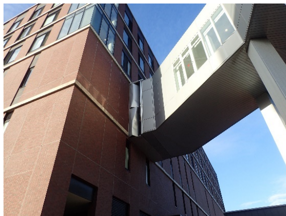
エキスパンションジョイントの損傷
