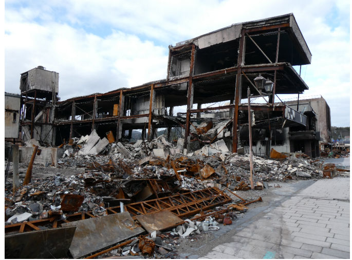
室内落下物による床の落下
