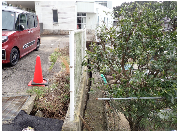
側方流動に伴う擁壁の変形
