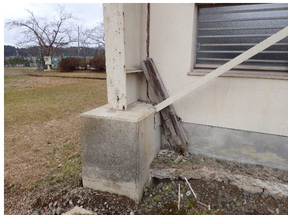
体育館ブレース端部の基礎ひび割れ
