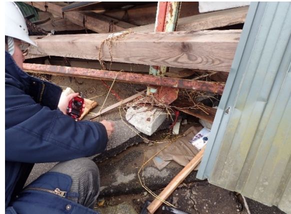
ダブル C 形鋼柱の脚部被害状況
