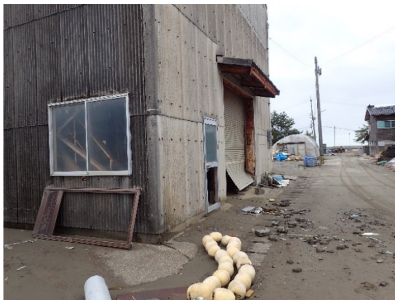
地震後の倉庫全体
