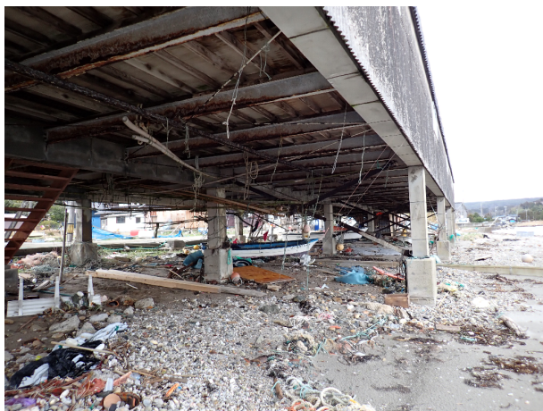
圧縮側・引張側ブレース破断
