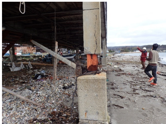
海岸側の柱の被害
