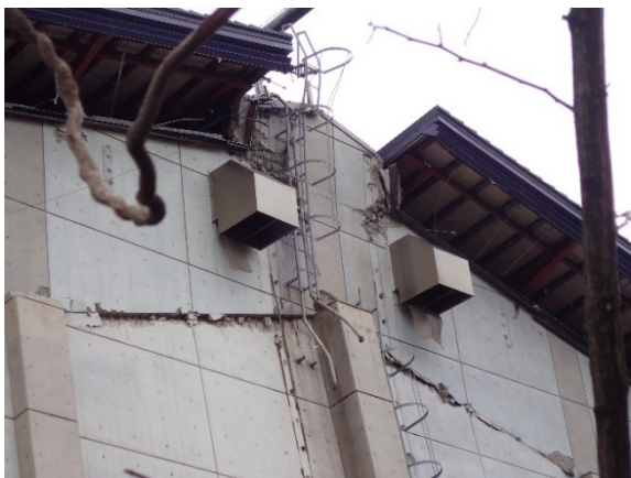
柱断面切替部分での耐力壁面外破壊
