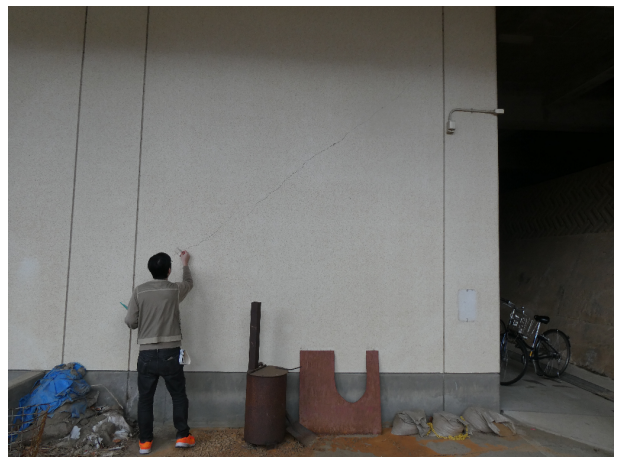
体育館のせん断ひび割れ
