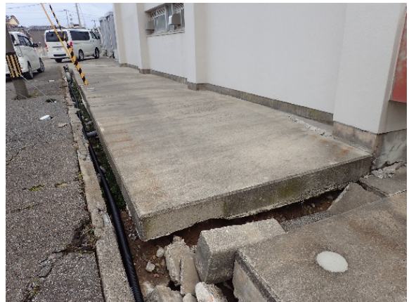
校舎周辺の地盤変状
