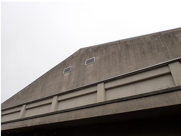
体育館 妻壁と梁接合部の損傷
