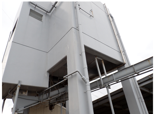
柔構面の柱梁接合部のひび割れ（外側）
