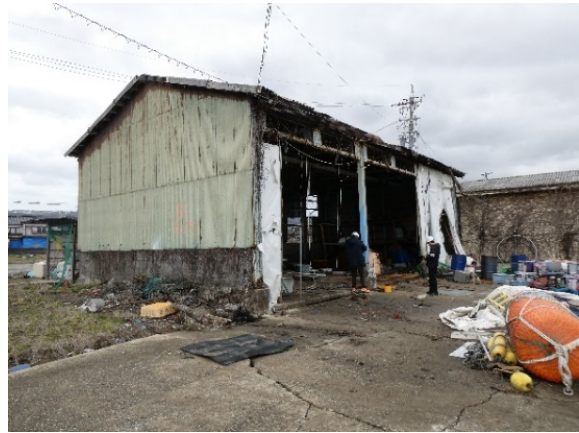
津波により入口が破壊した倉庫
