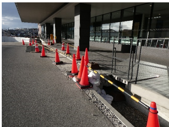
免震クリアランス部の損傷
