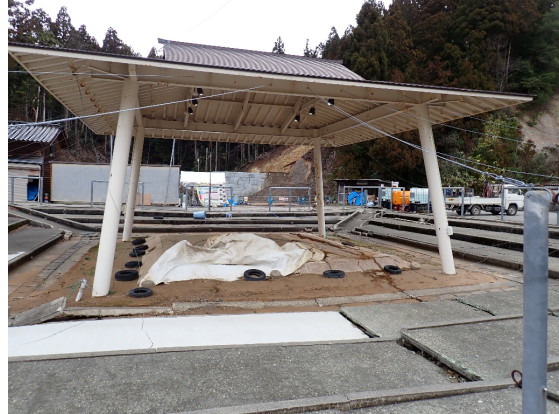
地割れで損傷した土俵
