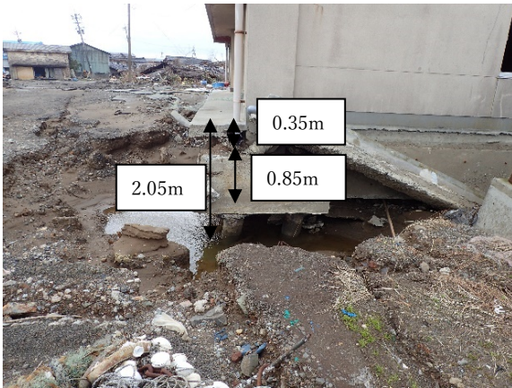
洗掘により露出した杭基礎
