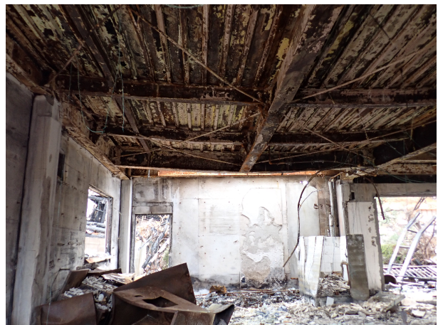
鉄骨屋根のたわみ変形
