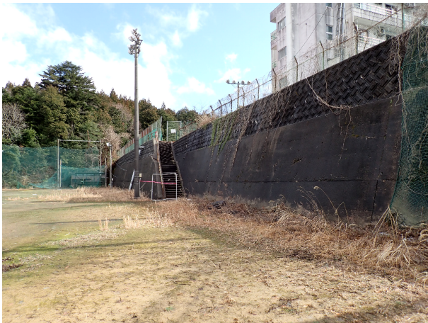
側方流動に伴う階段部分の変形
