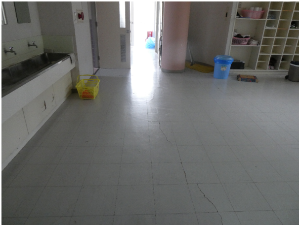
体育館の床スラブのひび割れ
