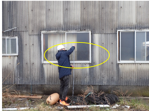
建物側面の浸水痕跡
