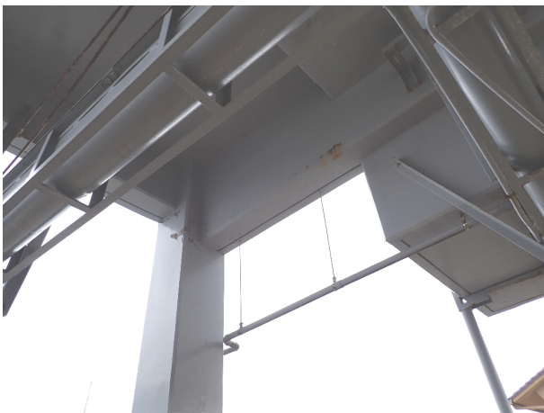
柔構面の梁および柱梁接合部のひび割れ（内側）
