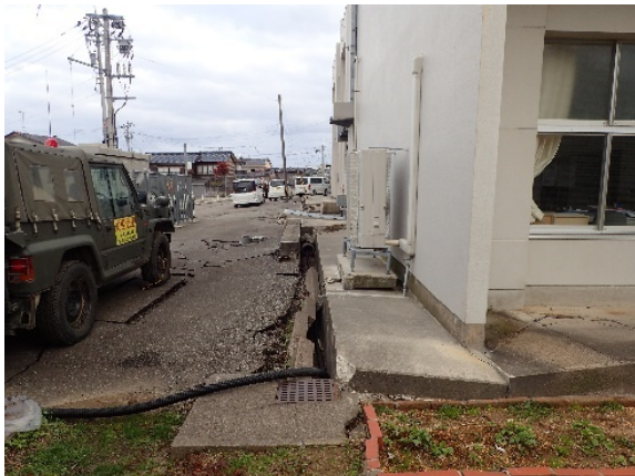
校舎周辺の地盤変状
