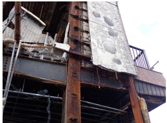
梁端接合部での剥離
