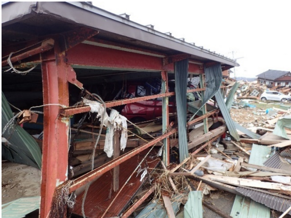
桁行構面の被害状況
