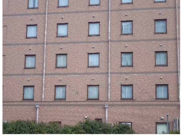
方立壁のせん断ひび割れ
