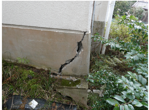
校舎の基礎端部の割れ
