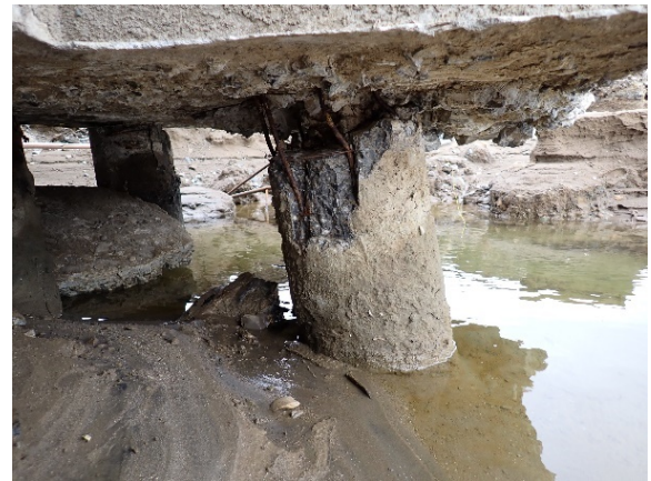
基礎杭の浮力によるせん断引張破壊
