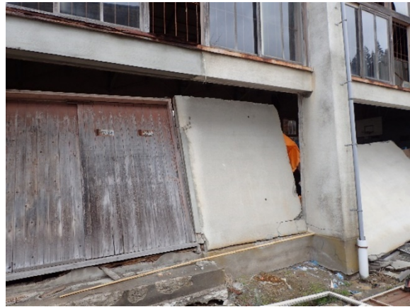
コンクリートブロック壁の面外転倒
