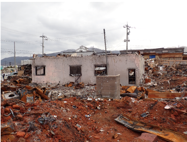
残存した鉄筋コンクリート+鉄骨屋根建物
