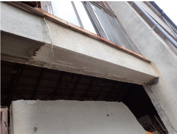
ブロック壁鉄筋の定着長さがほとんどない
