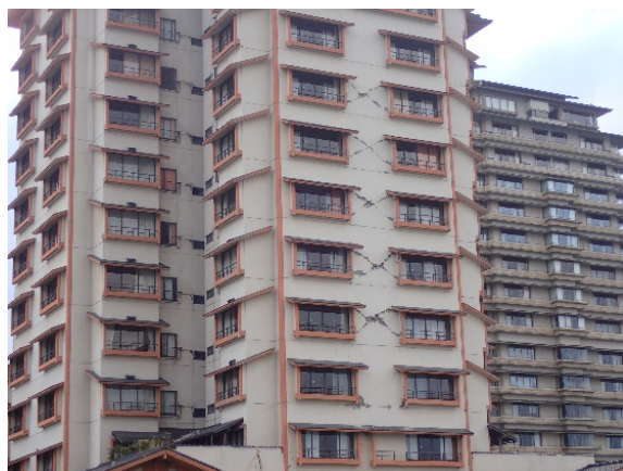
方立壁のせん断ひび割れ
