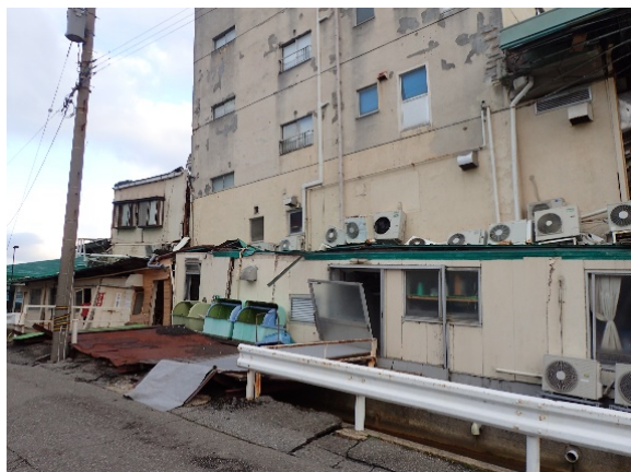
傾斜した建物の1階部分
