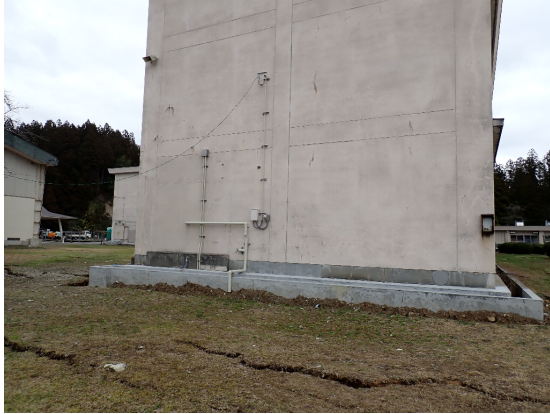
周辺の地割れと耐震補強校舎の傾斜
