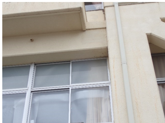
補強構面に接続する境界梁のひび割れ
