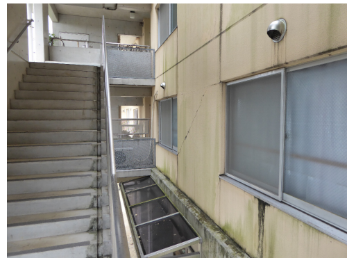
2階方立壁の損傷
