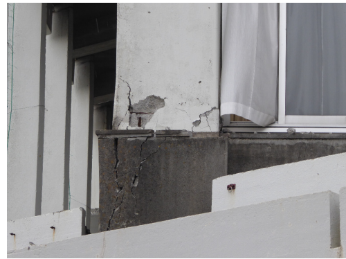
2 階柱脚部分の損傷
