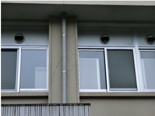
2階柱のせん断ひび割れ
