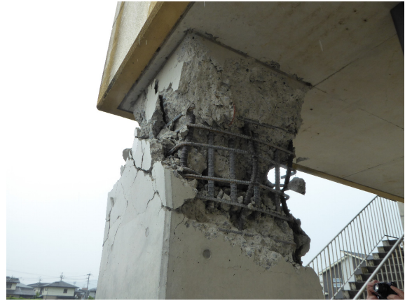
柱頭の損傷（主筋破断）
