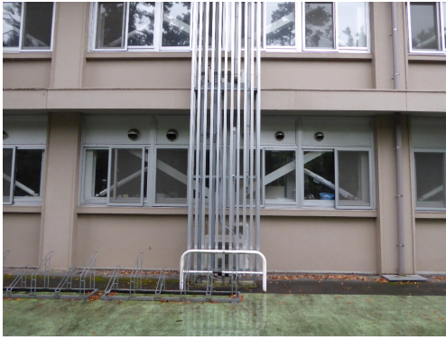
耐震補強ブレース
