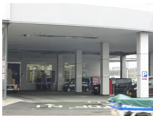
熊本市 天井の脱落被害
