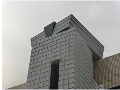
EV棟の被害
