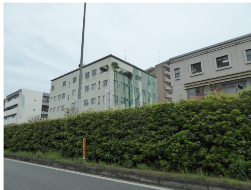
熊本市 病院の外壁（方立壁）の損傷
