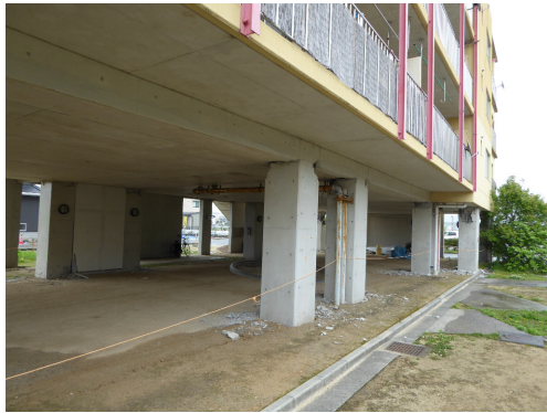
純ピロティ構面の被害
