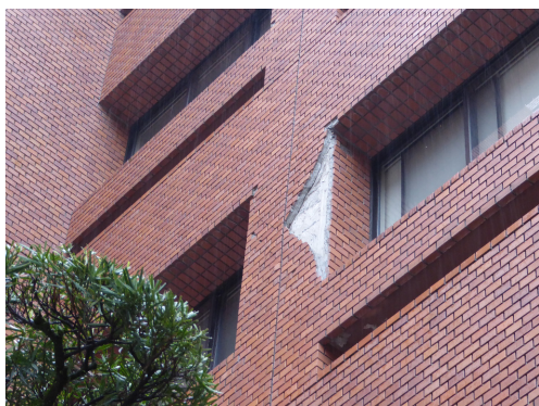
3階間柱のせん断ひび割れ
