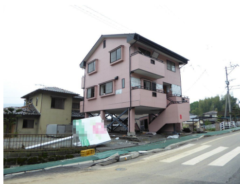
益城町 軽量鉄骨住宅（危険）
