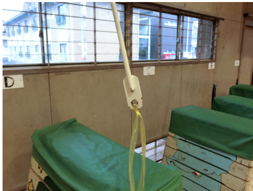
ボルト破断した既存屋根ブレース
