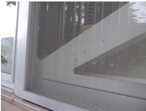
耐震補強ブレースの塗料剥がれ
