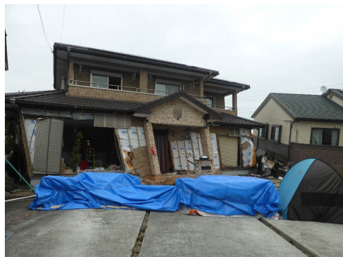
益城町 住宅の傾斜
