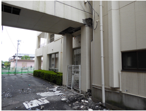
渡り廊下の損傷状況
