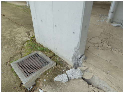
構面外壁の端部筋の損傷
