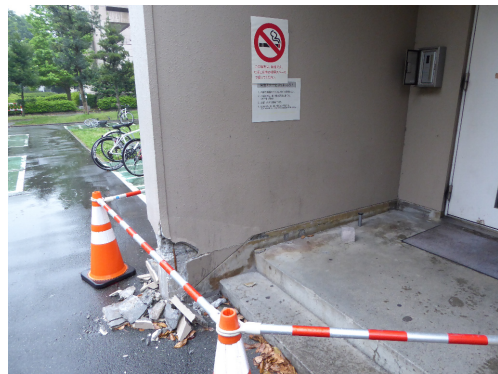
構面外壁の損傷
