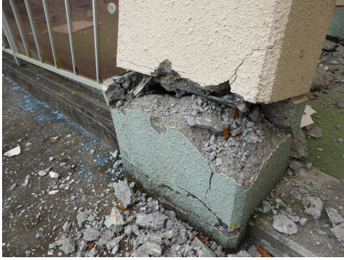
渡り廊下 主筋破断
