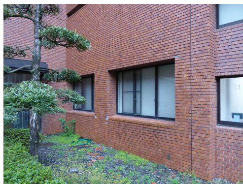
1階間柱のせん断ひび割れ
