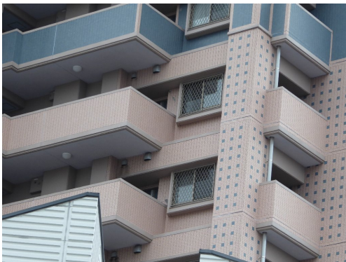
熊本市 RC13階集合住宅の非構造壁損傷
