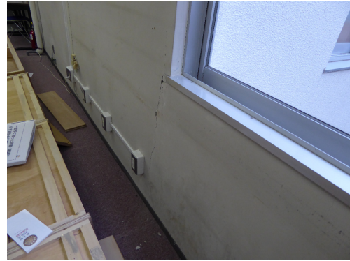
腰壁つき梁のひび割れ
