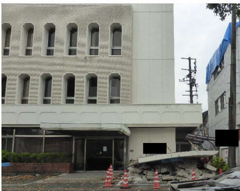
熊本市 外壁材の脱落
