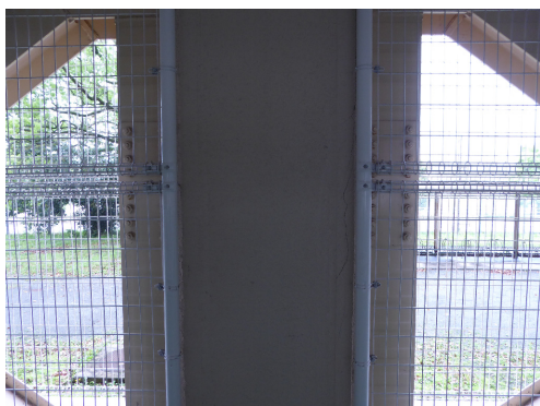
耐震補強ブレース接合部のひび割れ
