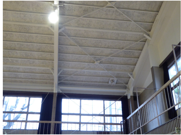
座屈したアングル屋根ブレース
