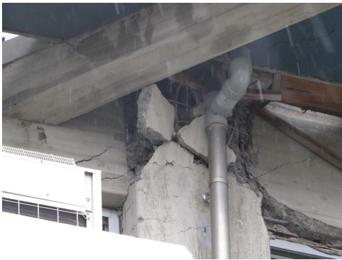
損傷した接合部の拡大写真
