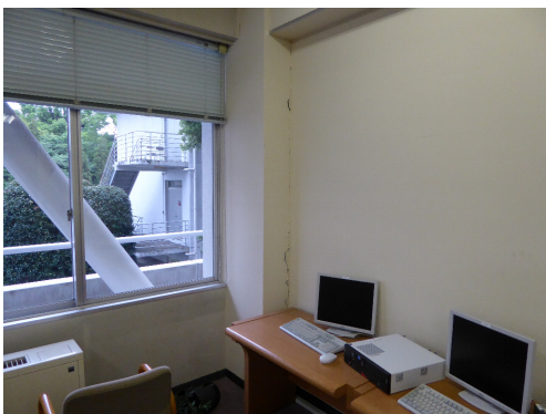
壁収縮目地でのひび割れ
