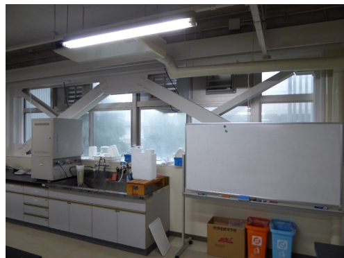
耐震補強ブレース
