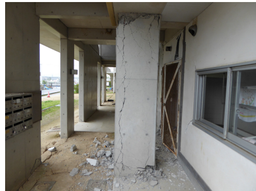
付着破壊した柱
