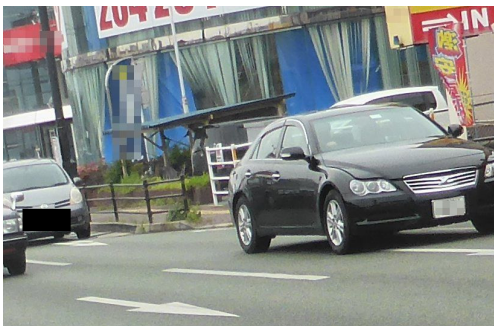
熊本市 全面窓ガラスの破損
