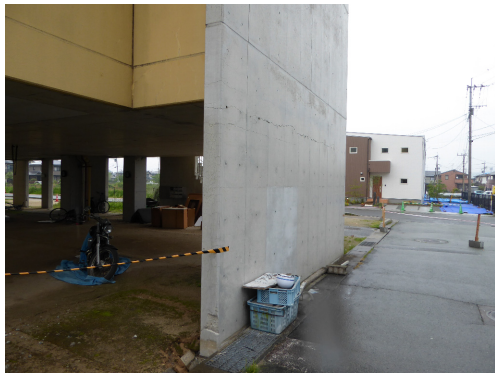
直交壁の面外ひび割れ
