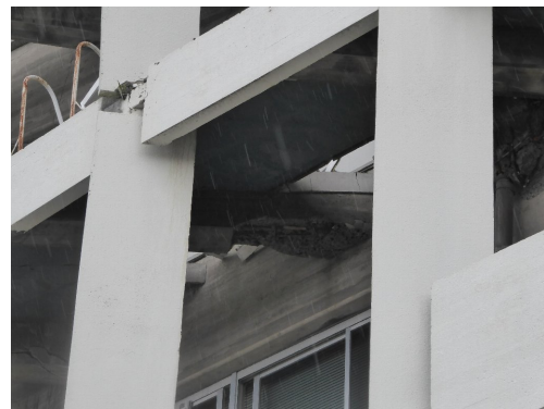
バルコニーを支える斜め梁の損傷
