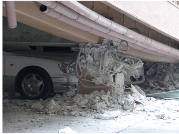
南構面に損傷したピロティ柱
