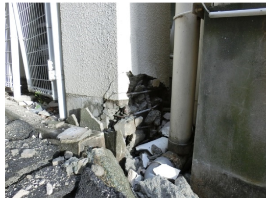
渡り廊下外端柱脚損傷
