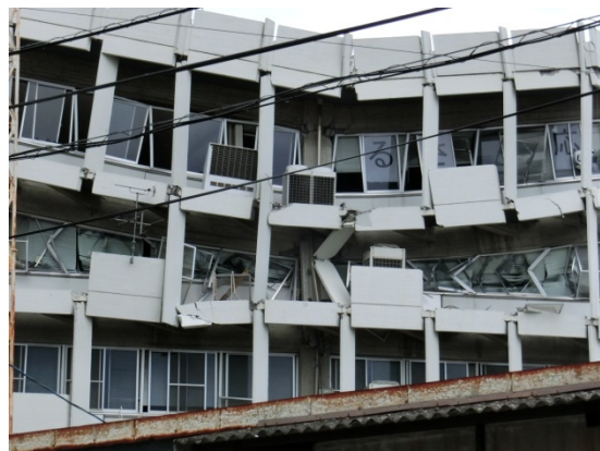
崩壊した 4 階部分（西面）
