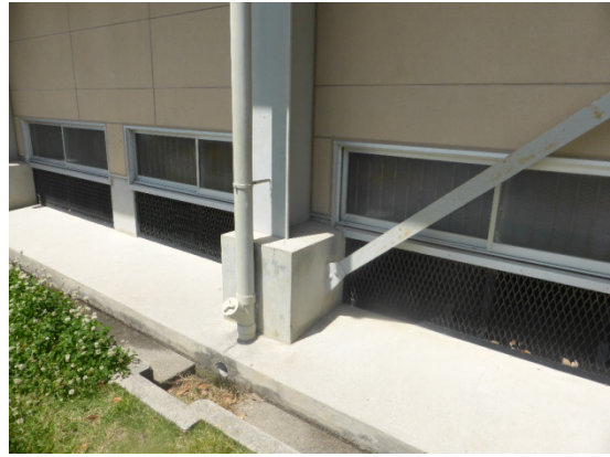
柱脚の根巻コンクリートのひび割れ
