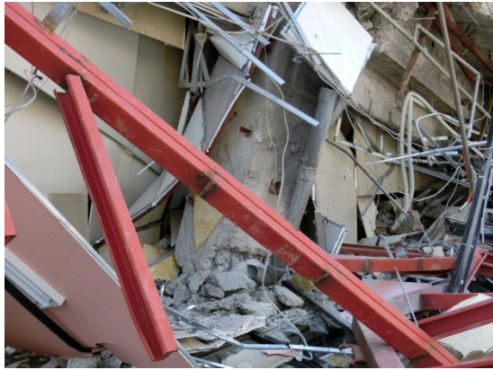
崩壊した1階の柱
