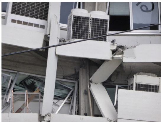
西側 4 階柱頭柱梁接合部の破壊
