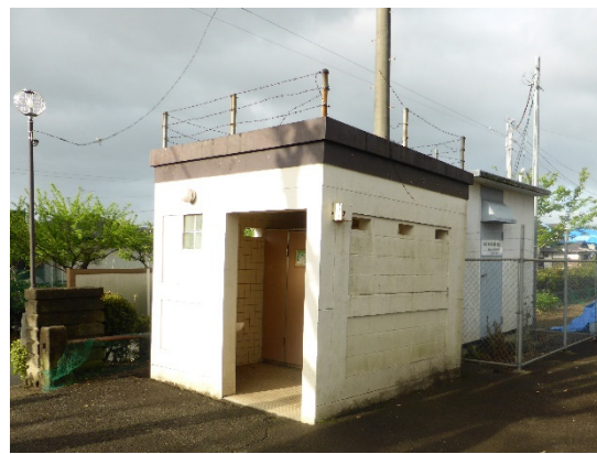
観測点に隣接するトイレの傾斜
