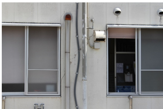
増築部の雑壁の損傷
