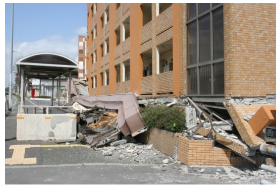
層崩壊した1階部分（西面）
