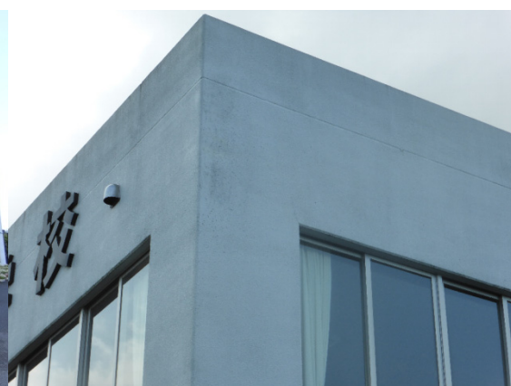
2階柱頭ひび割れ
