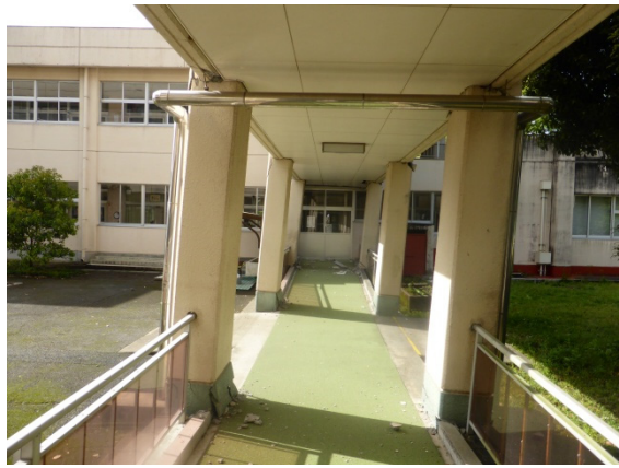
渡り廊下西棟の傾斜
