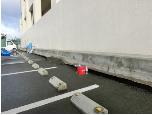
外付けフレーム基礎周辺地盤沈下
