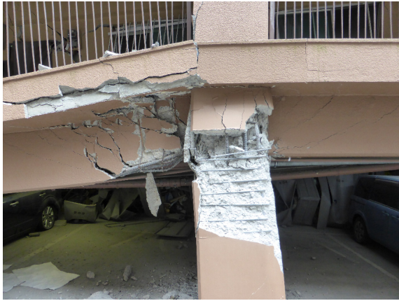
北構面で損傷したピロティ柱
