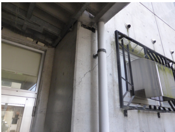
短柱のせん断ひび割れ
