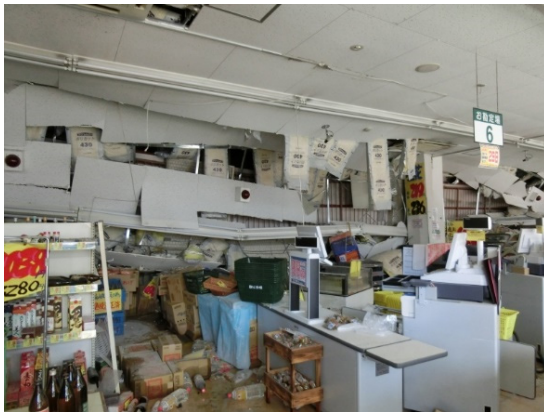
1階店舗内の様子（上階落下）
