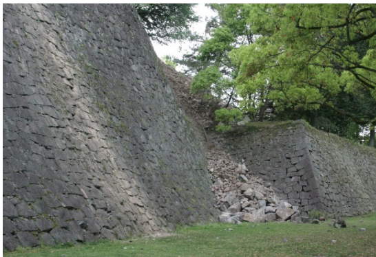
北十八間櫓および石垣の崩落
