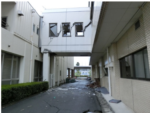
渡り廊下被害
