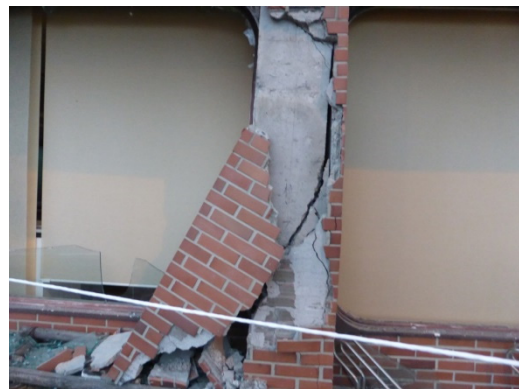
柱のせん断破壊
