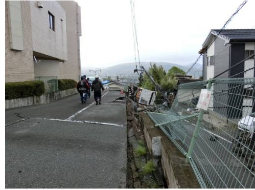
周辺地盤変状
