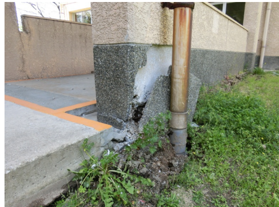
渡り廊下の柱脚部の破壊
