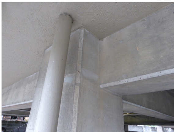
桁行方向の梁端ひび割れ
