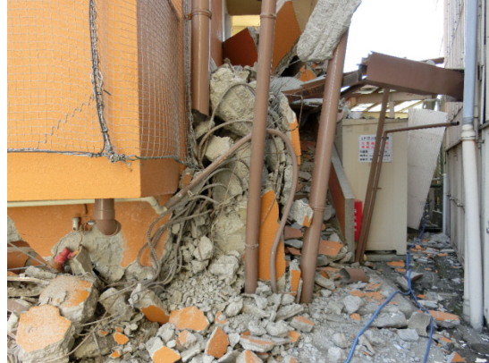
建築物北東側柱の破壊
