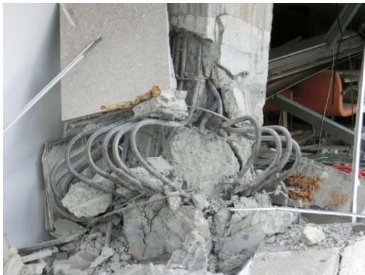
軸崩壊した柱
