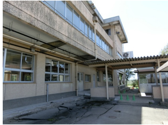
校舎周辺の地盤変状
