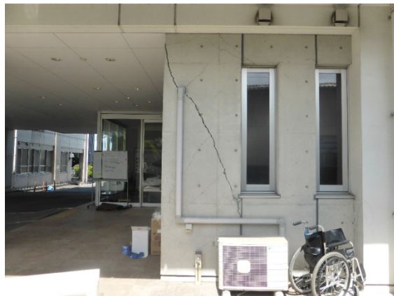
沈下による雑壁のせん断ひび割れ
