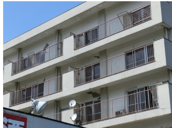
梁せん断破壊
