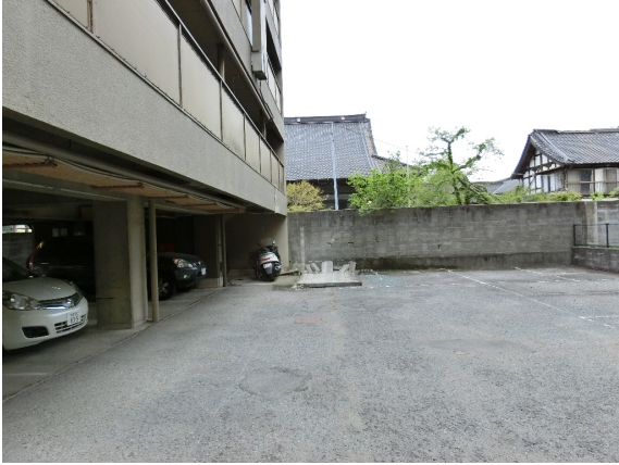
転倒した周囲のブロック塀
