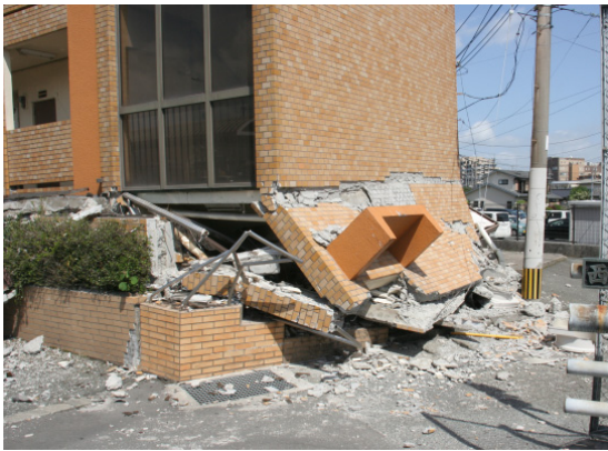
建築物南側妻壁の破壊
