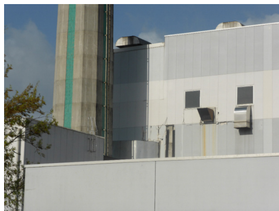
外壁仕上げ材の損傷
