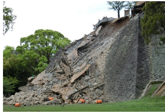
東十八間櫓および石垣の崩落
