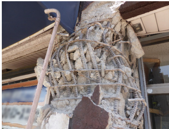
長柱柱頭段落とし部の破壊
