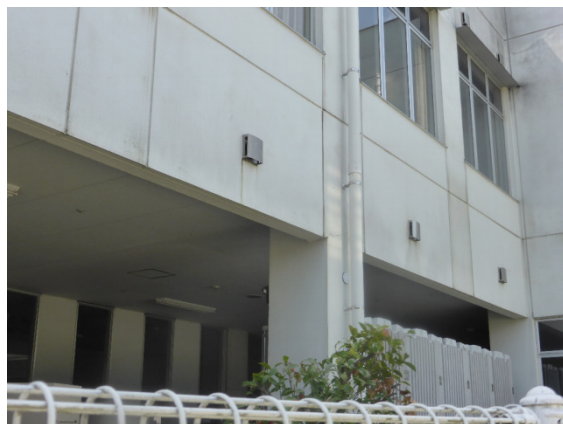
長柱柱頭部の曲げひび割れ
