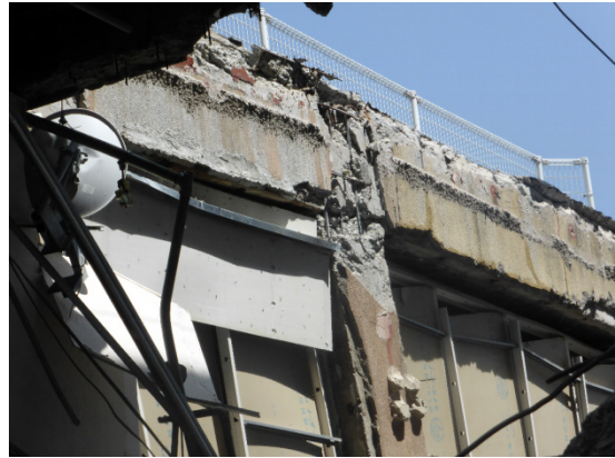
2階柱頭接合部の損傷
