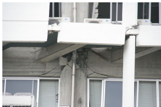
南側 4 階柱頭柱梁接合部の破壊
