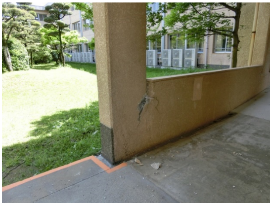
腰壁部の曲げひび割れ
