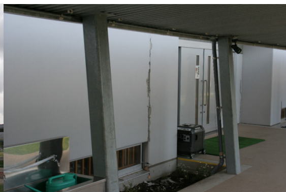
体育館の外壁材の剥がれ
