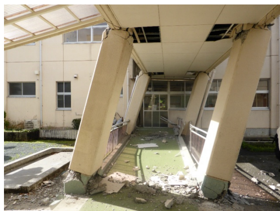
渡り廊下東棟の傾斜
