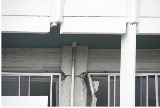
5階柱の柱頭の曲げ破壊
