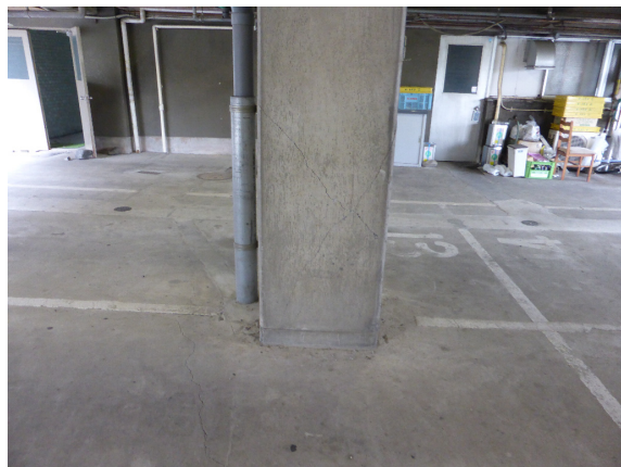
ピロティ柱のせん断ひび割れ
