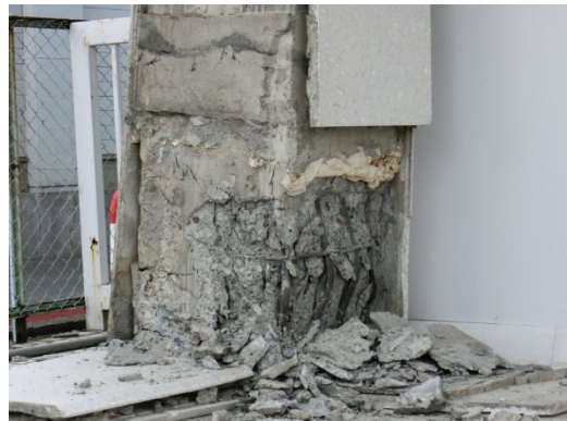
北西隅柱の損傷状況
